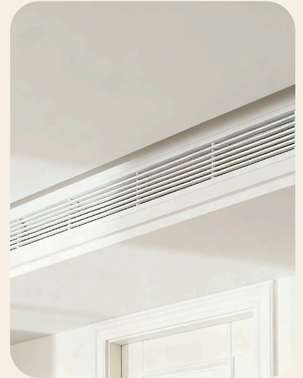
Climatización por conductos
