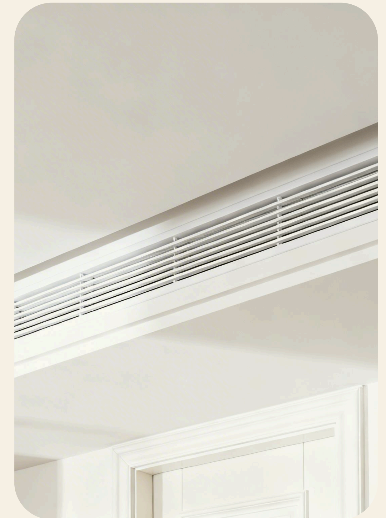
Climatización por conductos
